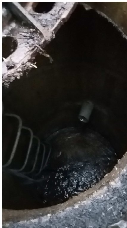
Détail de l'intérieur de la chambre du captage de Vuichard Est
