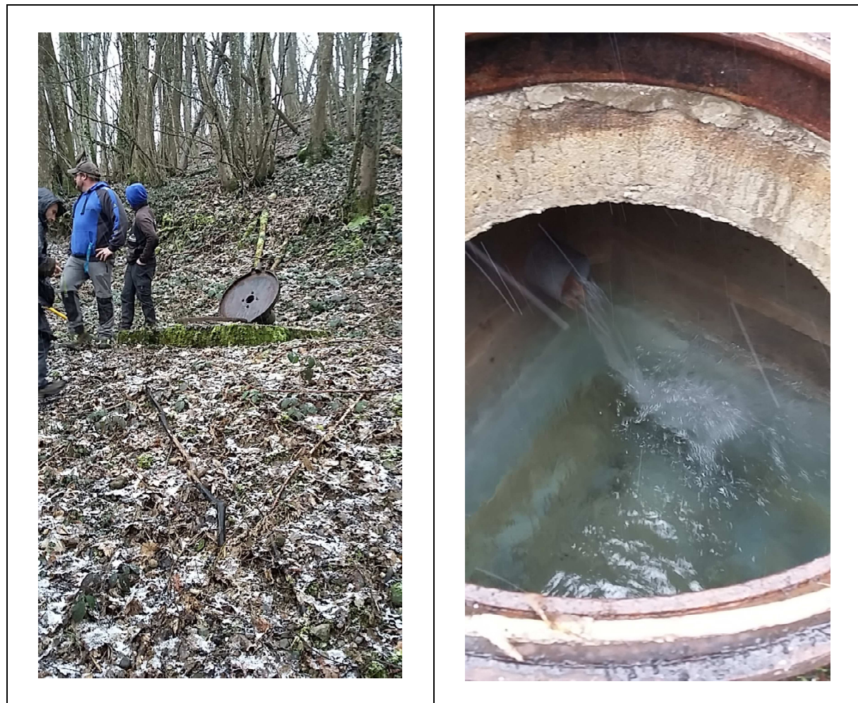
Figure 12 : Détails du captage du Mont
